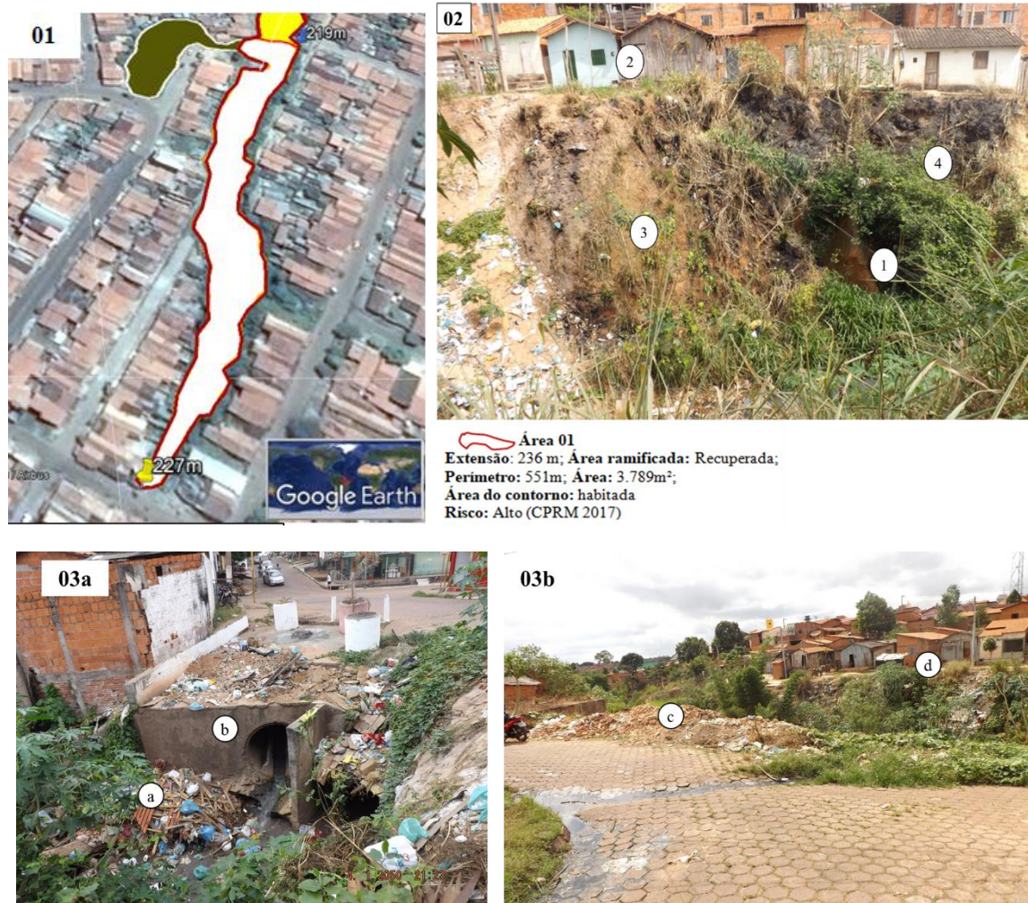
Figura 20: Principais aspectos por área da Voçoroca do Bairro Centro. (01) Área mais a montante e ocorrências da urbanização em (02), (03) e (04).
