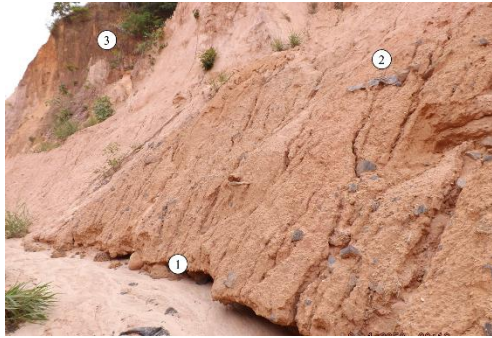
Figura 18 (cont.): Voçoroca do Bairro Barra Azul. (d) Área 02. (e), (f), (g) Área 03. (h) Área 4.
