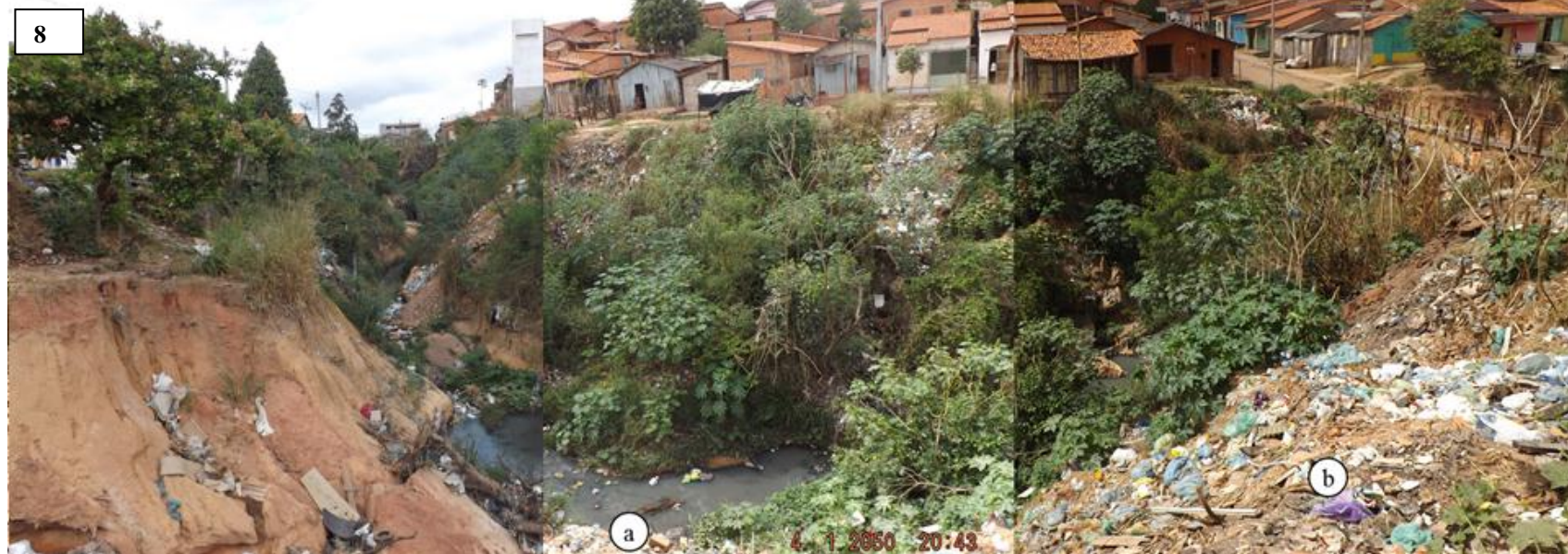
Percepção do risco (8): (a) Fundo do canal (presença de água); (b) Acúmulo de resíduos. Fonte: Pesquisa de campo (2018).
